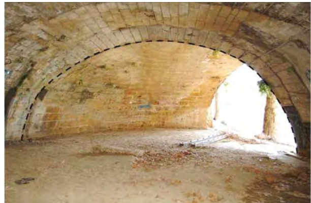
Fig. 5. Déformation de l'arc de la neuvième arche, située sous le quai rive gauche (cliché V. Mathieu – CNRS).
