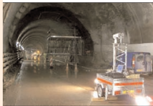
Le scanner 3D est positionné grossièrement à l'axe du tube pour assurer une densité radiale régulière.
